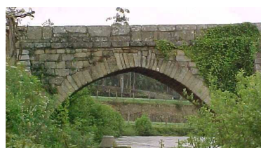
Figura 3: Deformação registada num arco da ponte.
