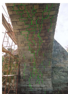
Figura 2: Padrão de fendilhação registado no intradorso de um arco da ponte
